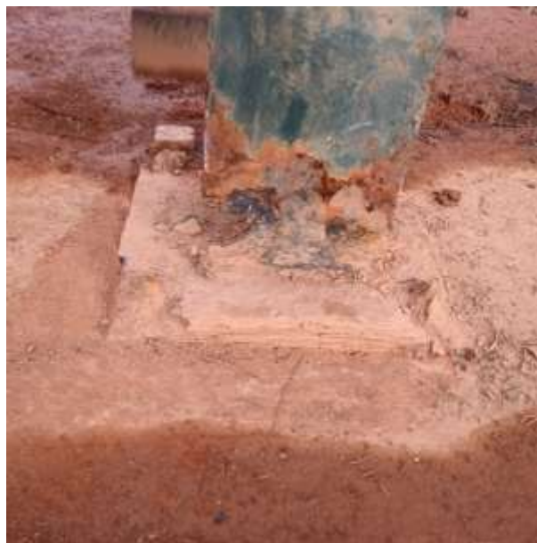
Foto n. 22 – Situazione colonne metalliche comuni alle coperture geodetiche dei campi n. 6 e 7, a seguito lavori di pulizia
