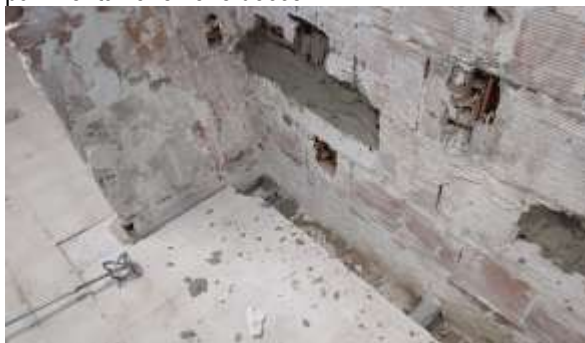
Foto n. 6 - Individuazione perdite impianto di scarico spogliatoi donne
