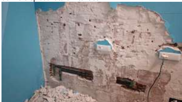
Foto n. 5 - Individuazione perdite impianto di alimentazione idrico-sanitaria spogliatoi donne
