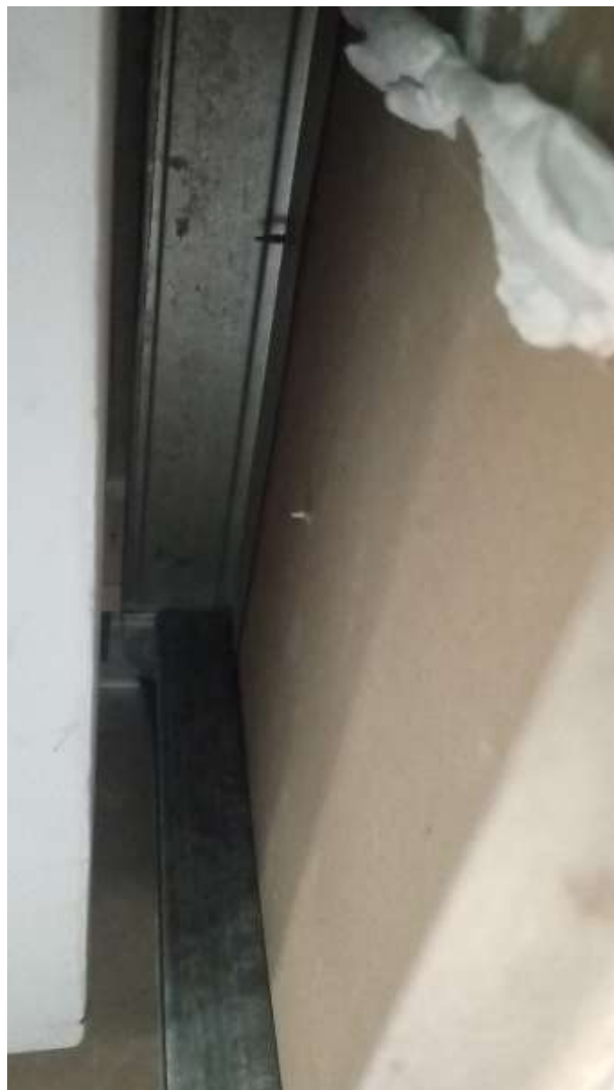
Foto n. 20 – Risultanze dell'attività ispettiva all'interno della controsoffittatura a seguito della quale si è constatato il fissaggio, con viti, delle lastre che imbibitesi di acqua, hanno incrementato notevolmente il proprio peso.
