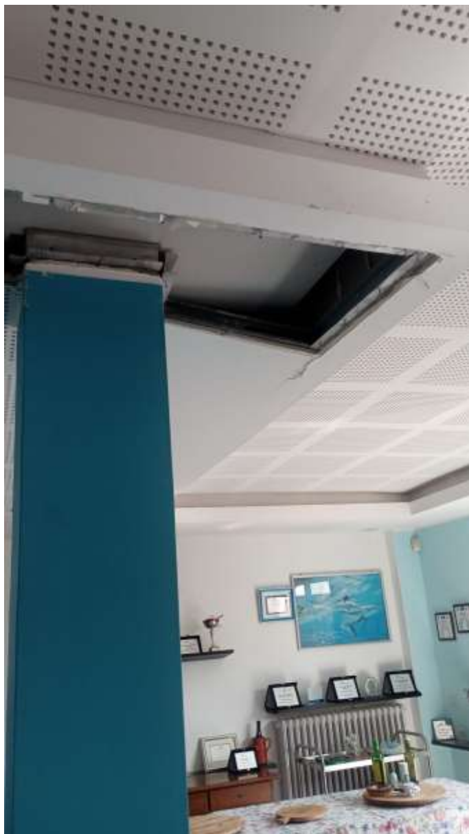
Foto n. 19 – Zona del controsoffitto deformata al piano primo che ha comportato attività ispettiva per determinare le cause del distacco
