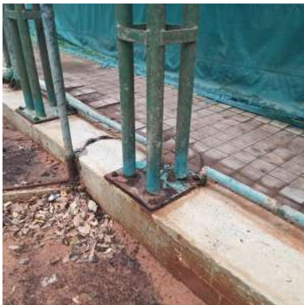
Foto n. 21 – Situazione colonne metalliche della struttura geodetica del campo n. 6, a seguito lavori di pulizia
