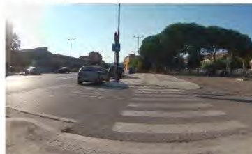
2. Mancanza di attraversamenti ciclopedonali idonei
